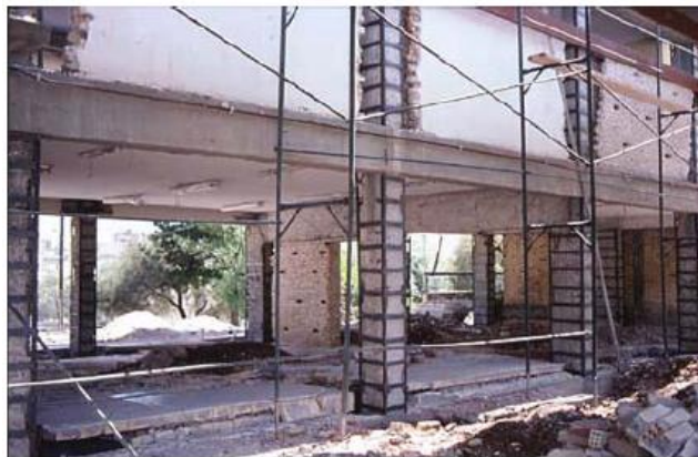
Figura 44 - Exemplo de encamisamento metálico de elementos de betão armado de secção rectangular, (adaptado de [21]).
